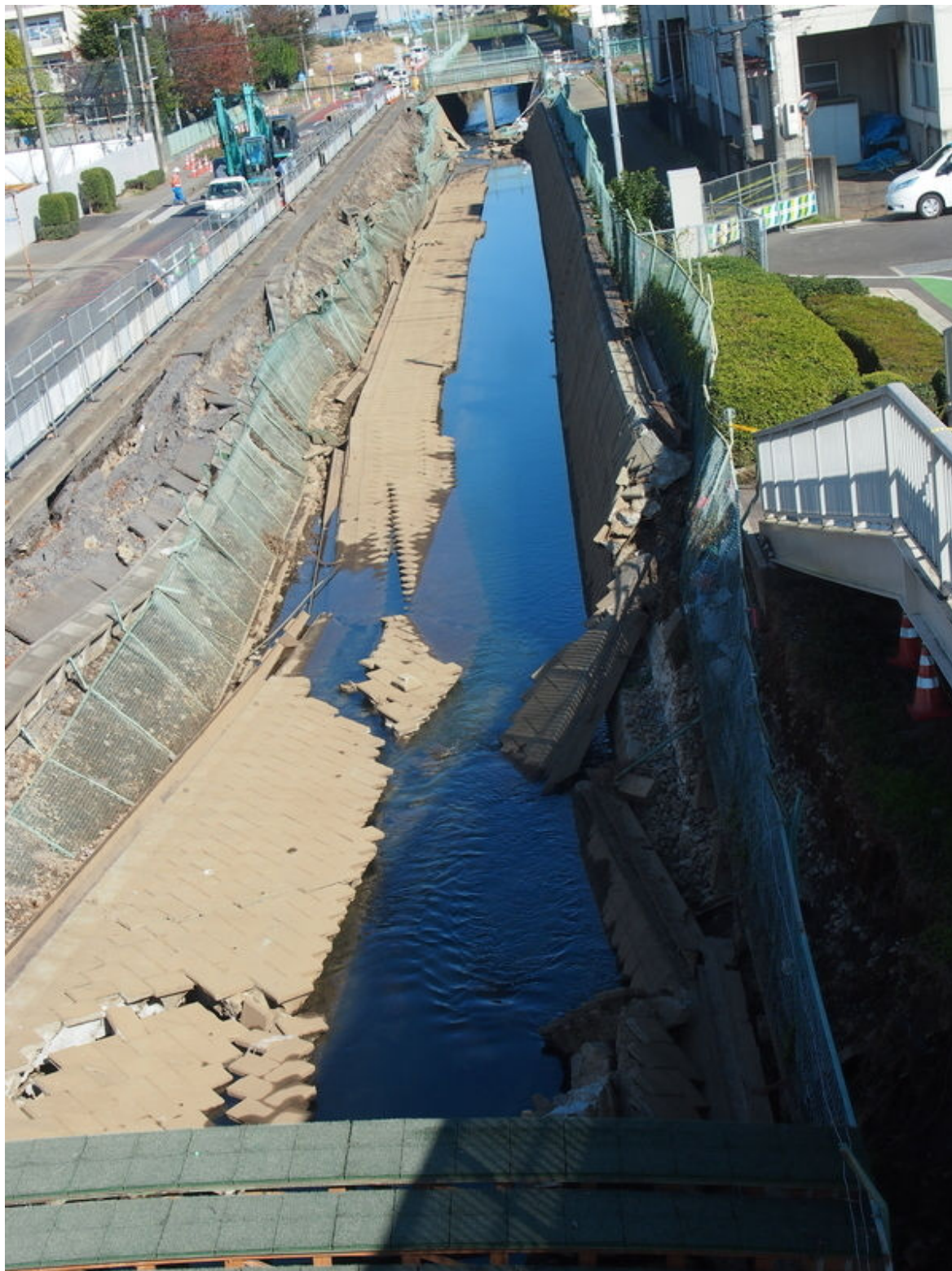
大量の水が流れて破損した江川都市下水路／筆者撮影
